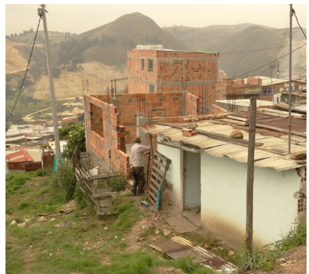
Un desplazado interno del Putumayo construye su propia casa en Altos de la Florida. Fotografía: Pablo Cortés Ferrández, 2018
